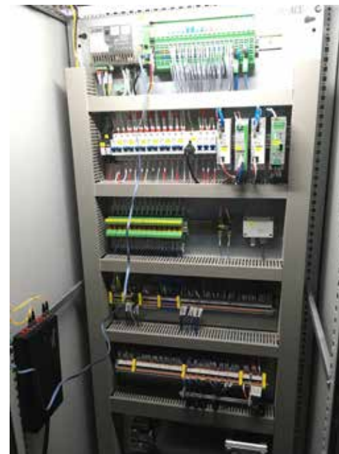
菲尼克斯电气提供了21套整体现场控制柜
